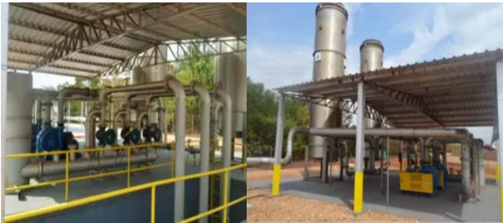
Figura 3 – Dutos de tratamento do gás metano
