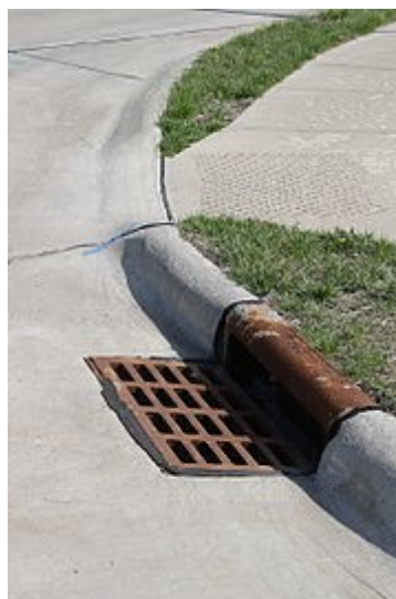
Figura 6: Boca de lobo.
