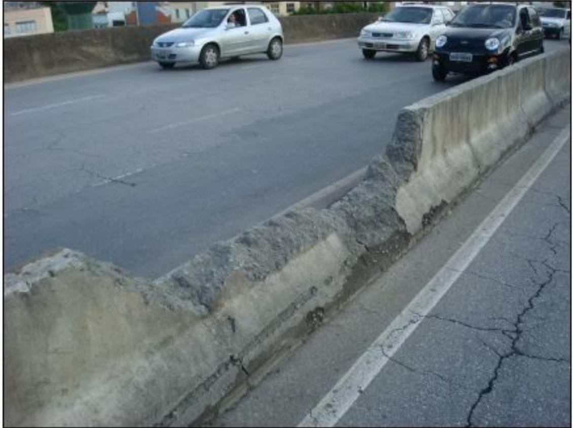
Imagem 3: Exemplo de deterioração do concreto.
