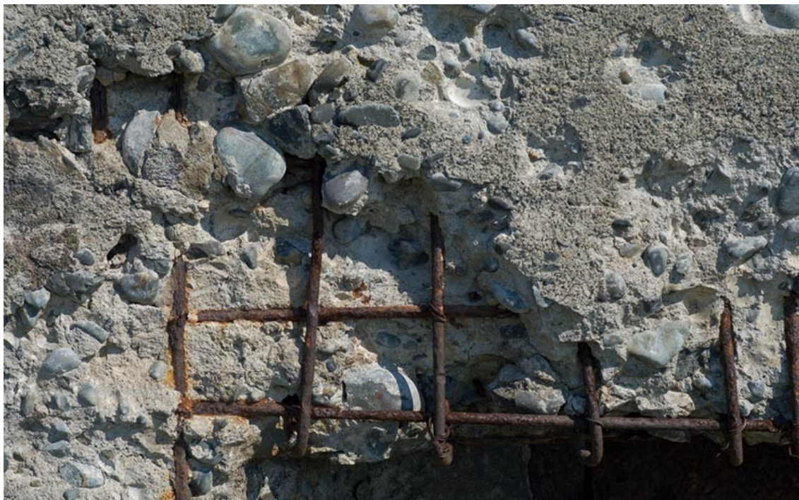
Imagem 4: Exemplo de corrosão da estrutura de aço.
