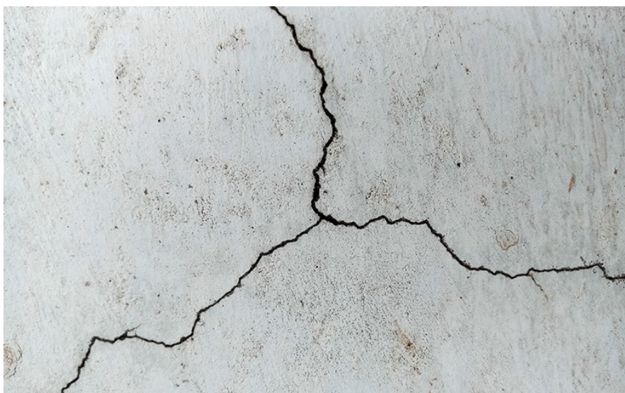
Imagem 1: Exemplo de fissuras. Fonte: www.mapadaobra.com.br .
