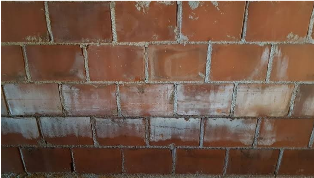
Imagem 6: Exemplo de eflorescência.
