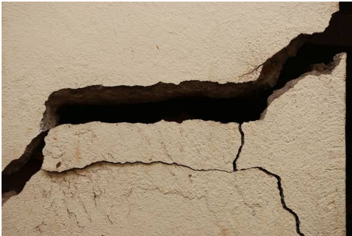
Imagem 2: Exemplo de rachadura.
