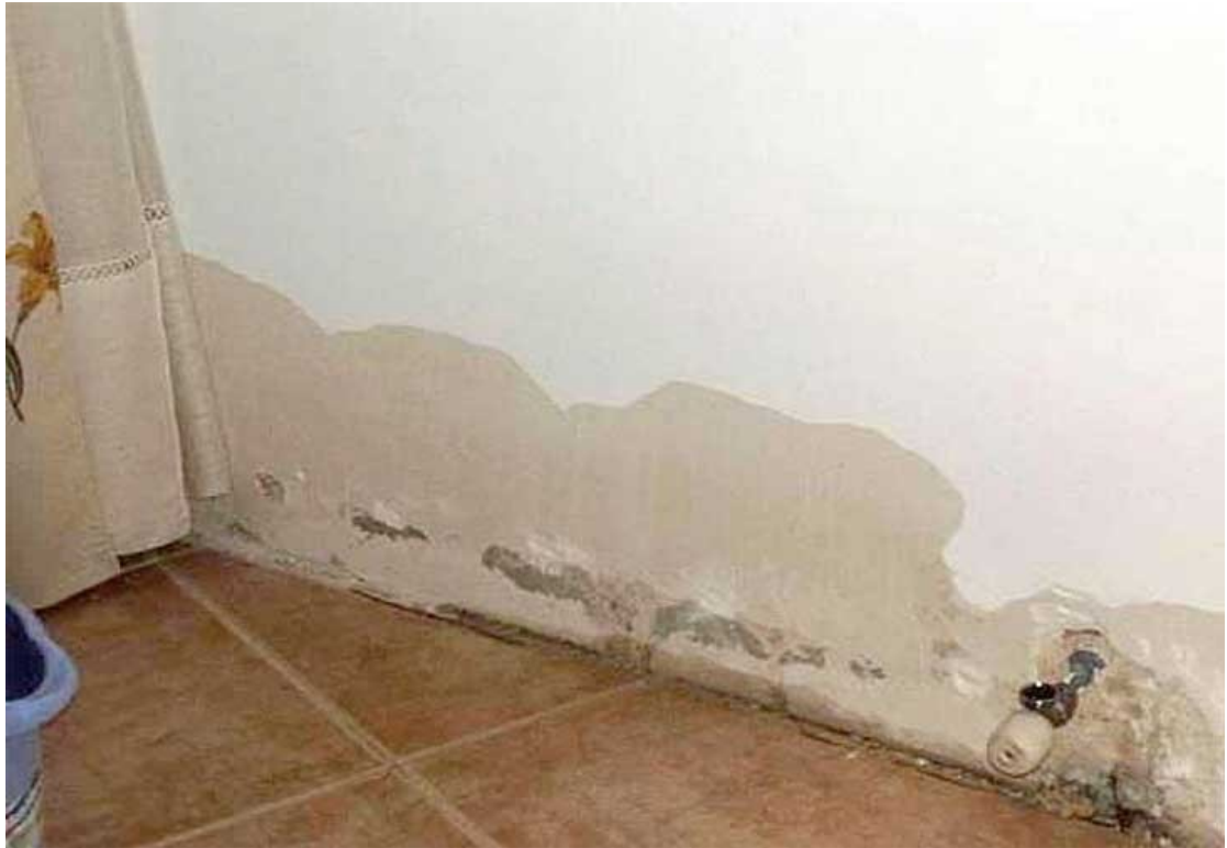
Imagem 5: Exemplo de manchas na parede de um edifício.
